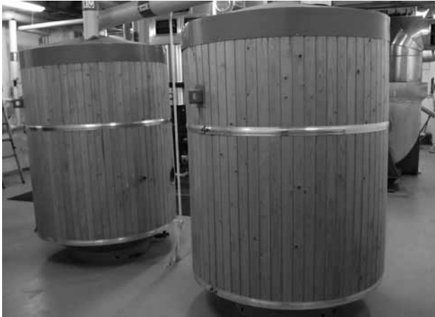
蓄熱槽 2,000ℓ×2 基のカバーは木製
